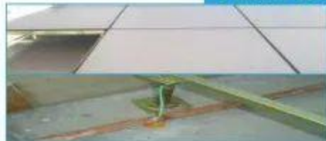
机房防雷接地
